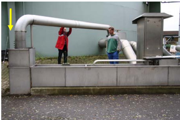
Abbildung 10: In Fließrichtung des Wassers vorderer Teil (Anlage 1) der Gesamtanlage.
