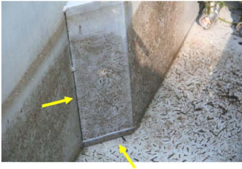
Abbildung 12: Nicht abgedichtete Anschlussstellen für das Führungsblech. Die beiden Pfeile weisen auf diese Undichtheit hin.
