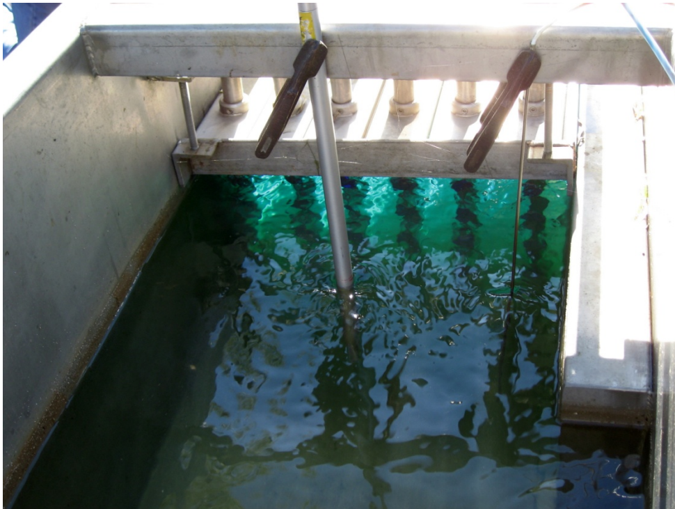
Abbildung 3 Einbausituation der Flügelradsonde an einer Messlotrechten
