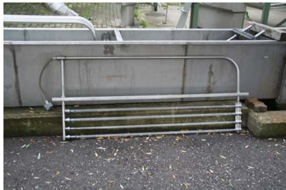
Abbildung 9: In Fließrichtung des Wassers hinterer Teil (Anlage 2) der Gesamtanlage.
