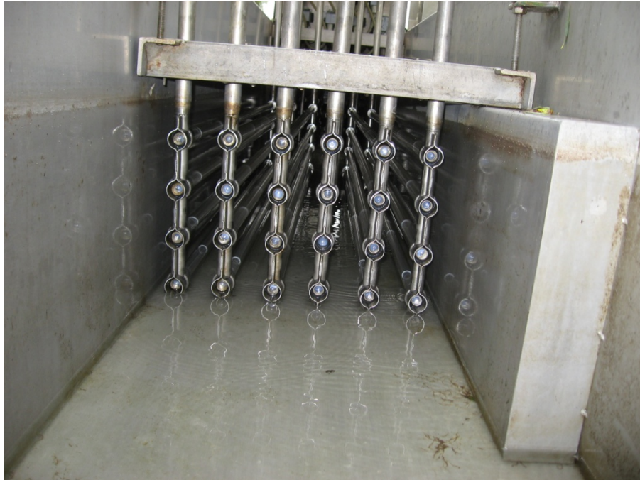
Abbildung 2 Austritt der UV-Anlage (2. Strahlerbank)
