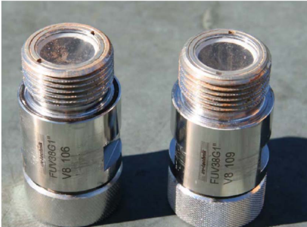
Abbildung 15: Messfenster nach längerer Verwendung in der Desinfektionsanlage. Die Verschmutzungen beeinträchtigen das Messresultat stark.
