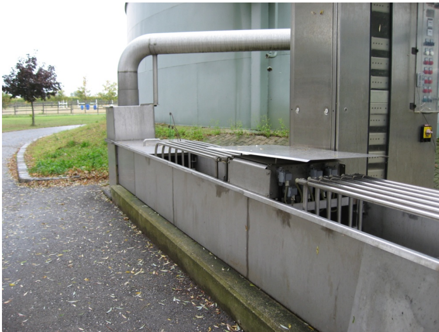
Abbildung 1 Gesamtansicht der UV-Anlage
